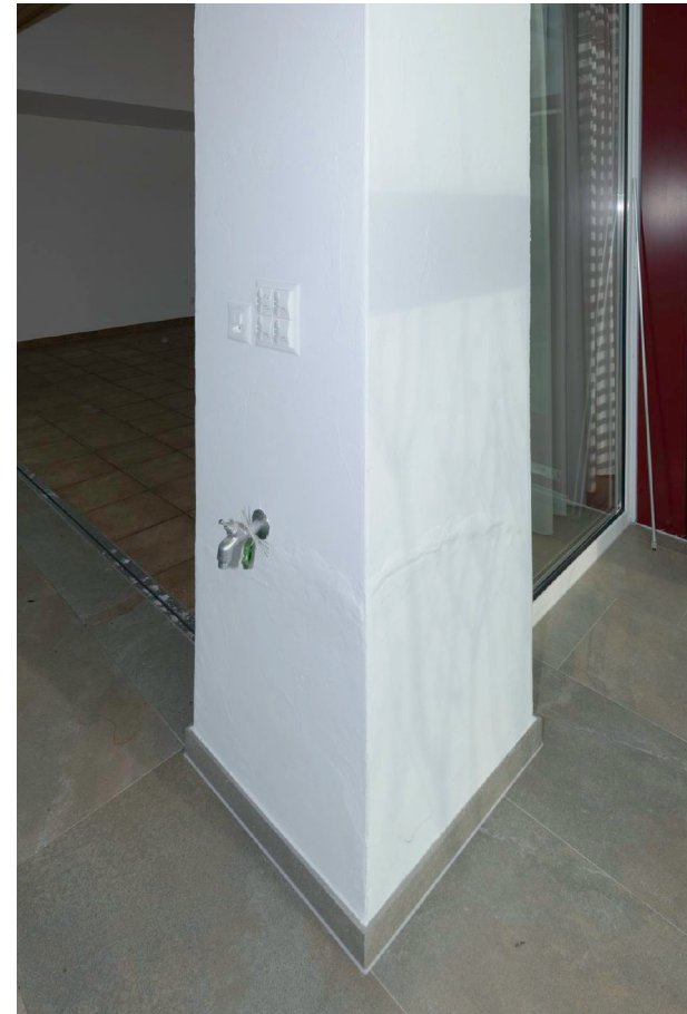
Der Wasserschaden beim Wintergarten
