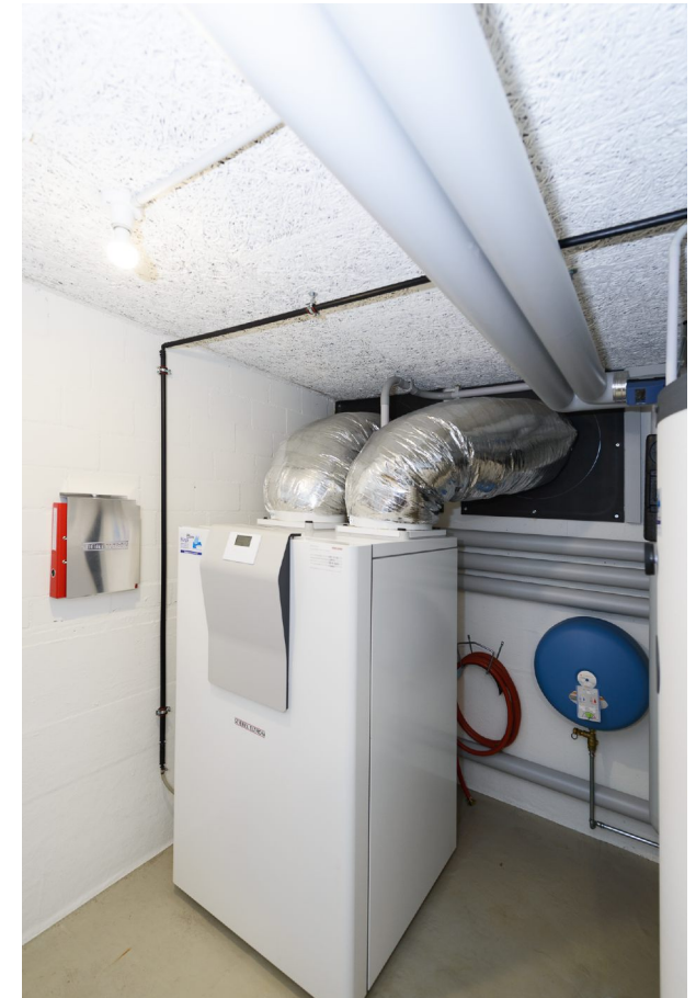
Die neue Luft-Wasser-Wärmepumpe im Untergeschoss
