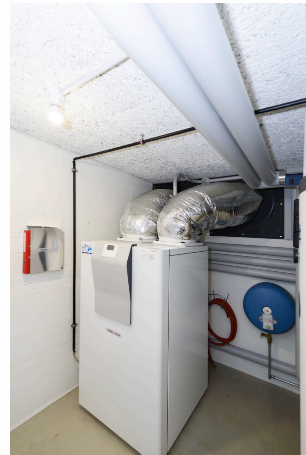
Die neue Luft-Wasser-Wärmepumpe im Untergeschoss
